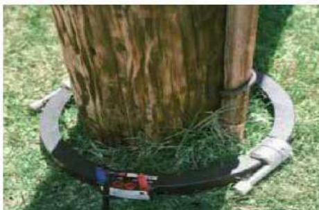
Figura 7. Transformador de corriente para abrazar todo el poste
